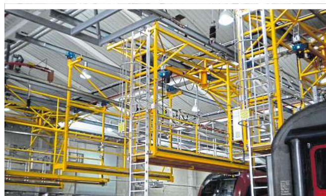
Die Dacharbeitsbühne erleichtert Wartungsarbeiten
